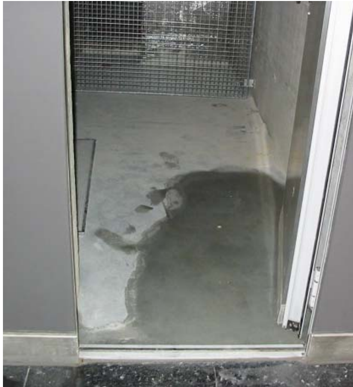
Wasserablauf am höchsten Punkt in der Zentrale !!
