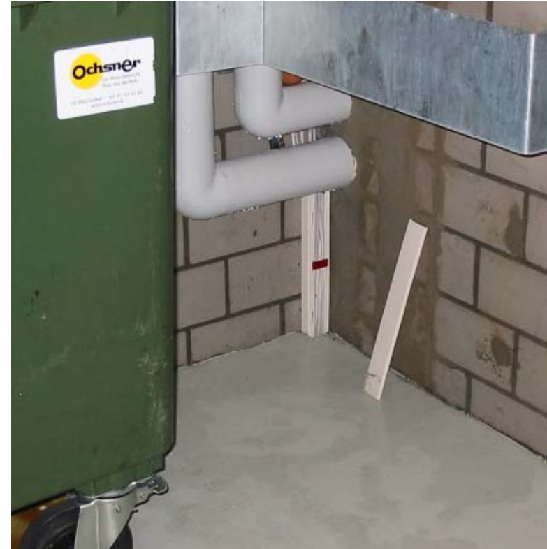
Containerraum mit Sprinkler aber ohne Ablauf !!
