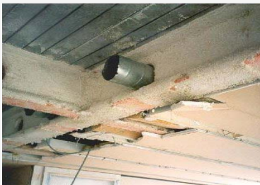
Spritzasbest auf Stahlträgern
