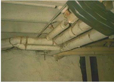
Asbesthaltige Rohrisolationen (Mörtel)
