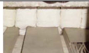
Asbestkissen zur Brandabschottung Asbestkissen z. B. in Wanddurchführungen von Kabelkanälen (Stoffgewebe und Füllung meist aus reinem Asbest)
