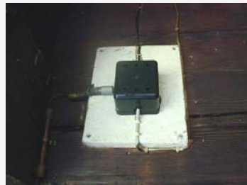
Asbestkarton bei Elektroverteiler
