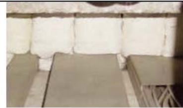
Asbestkissen zur Brandabschottung Asbestkissen z. B. in Wanddurchführungen von Kabelkanälen (Stoffgewebe und Füllung meist aus reinem Asbest)
