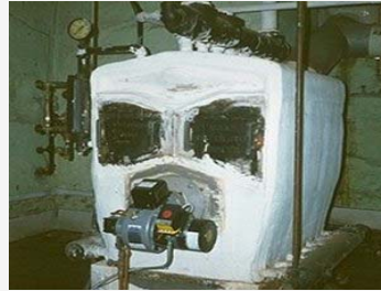
Wärmeisolation an einem Kessel
