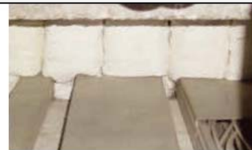
Asbestkissen zur Brandabschottung Asbestkissen z. B. in Wanddurchführungen von Kabelkanälen (Stoffgewebe und Füllung meist aus reinem Asbest)
